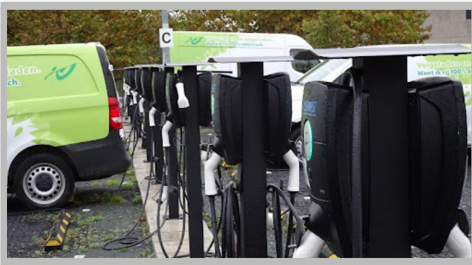
Elektro-Ladeinfrastruktur braucht Platz
