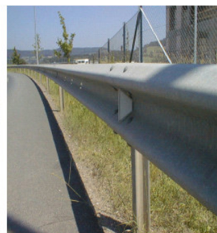
Réflecteur dans le creux de la glissière
